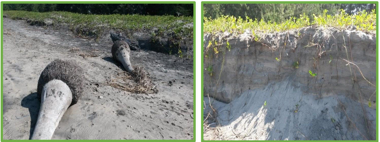
Figura 1: Presença de troncos de coqueiros na praia (esquerda) e erosão das dunas na praia (direita)
