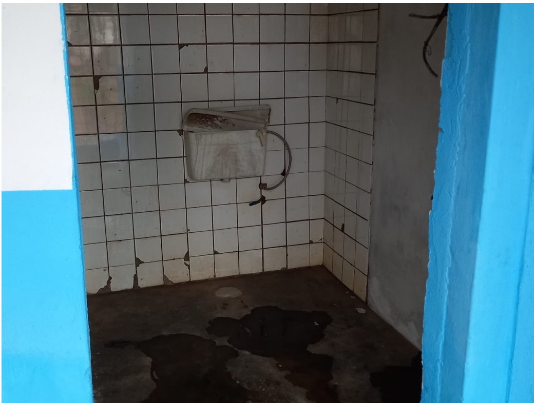
Apêndice 6- Estado interior casas de banho
