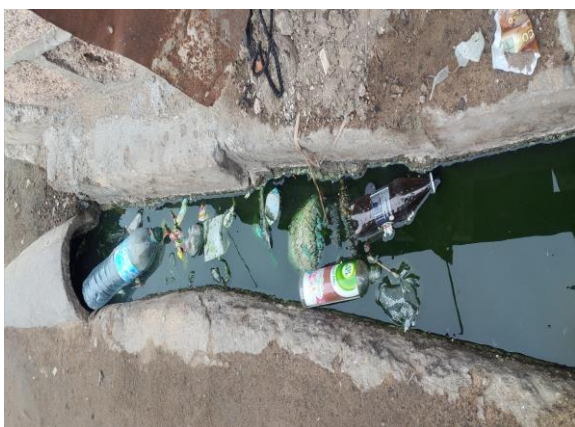
Figura 1: Presença de lixo nas valas
