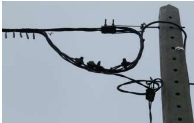
Figura 1: Rede aérea de BT em cabo torçado (Fonte: comum.rcaap.pt)
