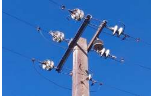
Figura 8: Isoladores inseridos em cadeia de amarração no apoio (Fonte: comum.rcaap.pt)
