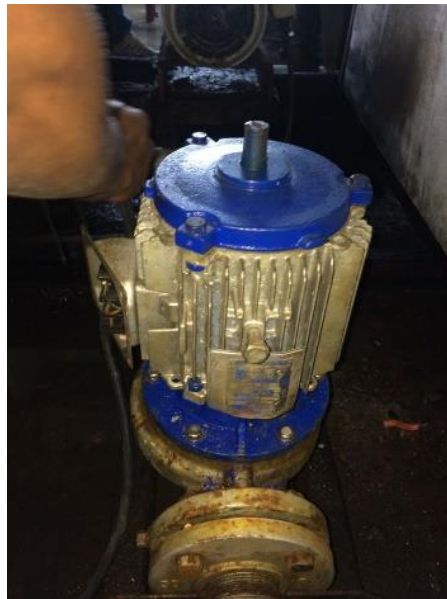
Fotografia 5: Bomba de água montada
