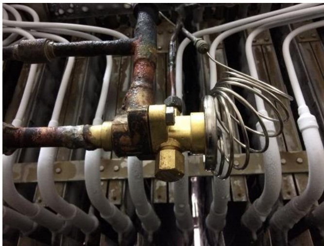
Fotografia 8: Válvula de expansão montada
