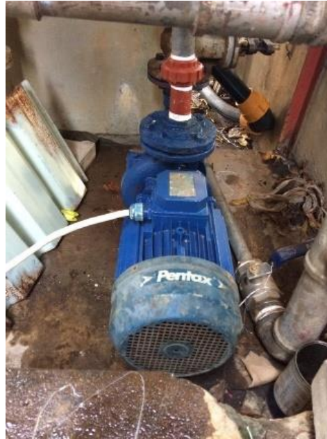
Fotografia 4: Bomba de água
