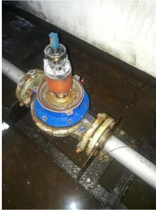
Fotografia 6: Bomba de água desmontada
