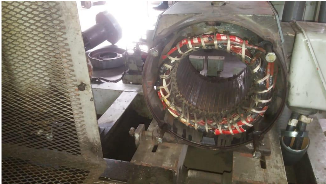
Fotografia 2: Estator do motor eléctrico
