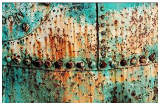
Figura 13: Acção corrosiva do mar em bóia marítima
