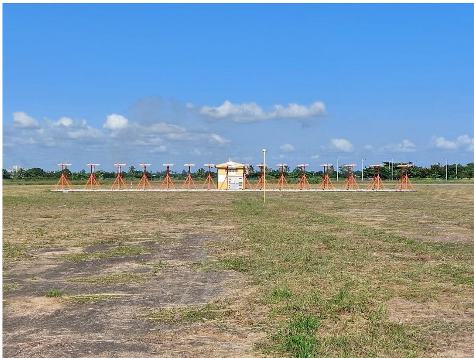
Figura do anexo II- Antenas e cabine do LLZ (do autor)
