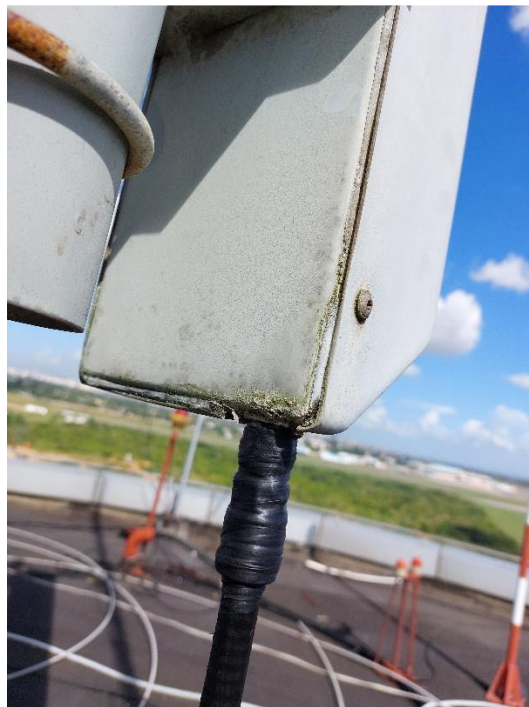
Figura do anexo XXI- Antena ADS-B depois da limpeza (do autor)
