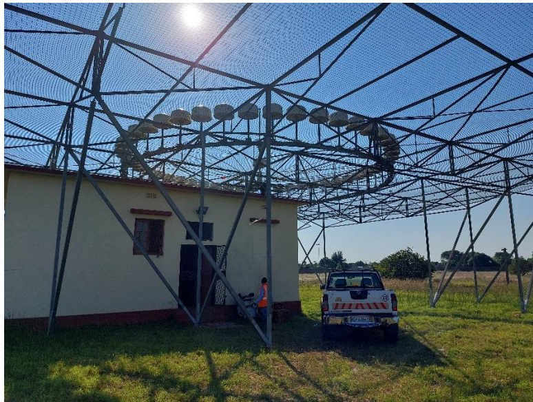
Figura do anexo XXIII- Estação DVOR/DME
