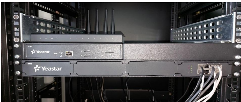
Figura 9- Central PABX para o serviço VOIP (do autor)
