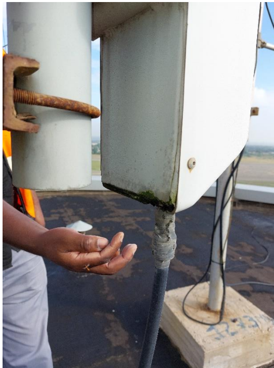
Figura do anexo XIX- Antenas ADS-B antes da limpeza (do autor)
