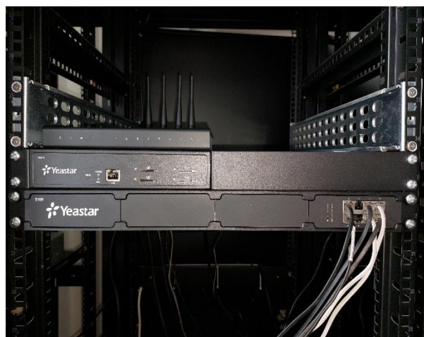
Figura do anexo XI- Central PABX vista frontal (do autor)
