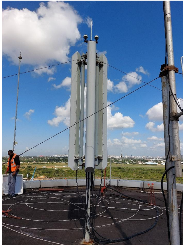
Figura do anexo XXII- Antenas sectoriais ADS-D no terraço da torre de controlo (do autor)
