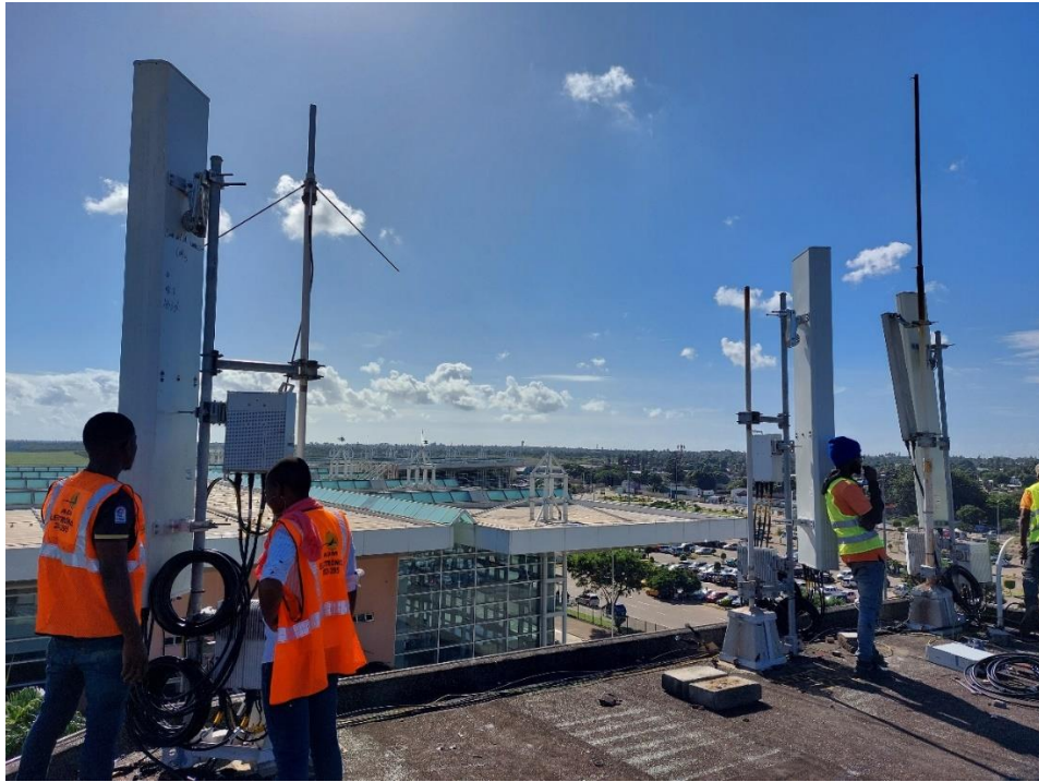
Figura do anexo XV- Equipa da Movitel e estagiários TMCENA trabalhando na substituição das antenas sectoriais (do autor)
