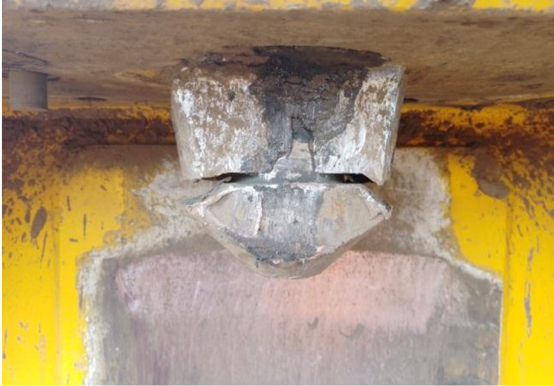
Imagem 3: Bush e Twistlock apresentando desgaste excessivo (Fonte: Do autor).
