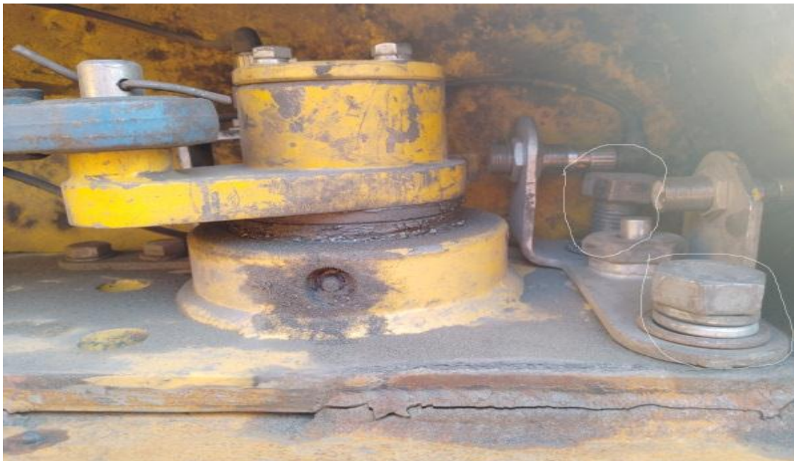
Imagem 2: Roscas do parafuso e base danificadas (Fonte: Do autor ).
