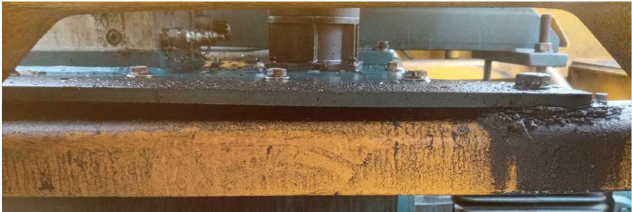
Imagem 5: Ilustração de desgaste acentuado do apoio B (Fonte: Do autor).
