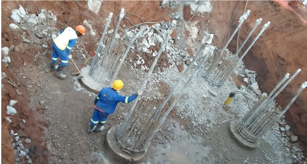
Figura 9: Saneamento das estacas (Fonte: Autor)
