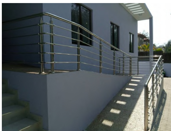
Figura 40. Guarda-corpos em rampa (fonte: Autor)
