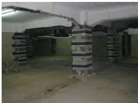
Figura 2. Reforço de pilares (fonte: Julio Appleton, 2014)
