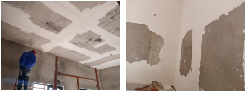
Figura 31. Barramento de tecto (1); Barramento de parede (2) (fonte: Autor)
