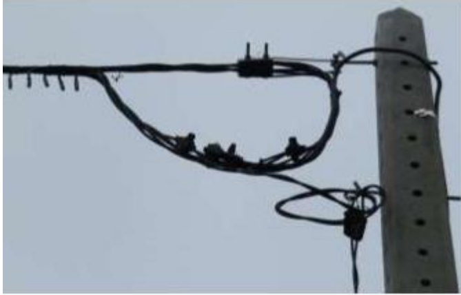
Figura 1: Rede aérea de BT em torçada
