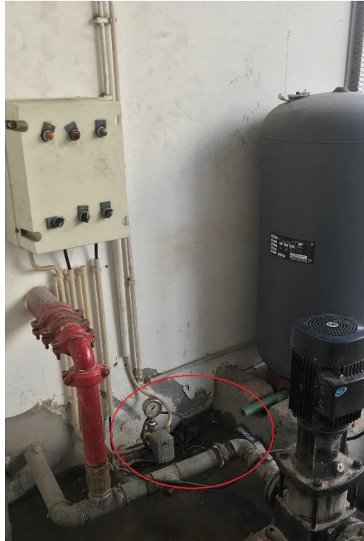
Figura 26- Hidropressor presente, porém não conectado
