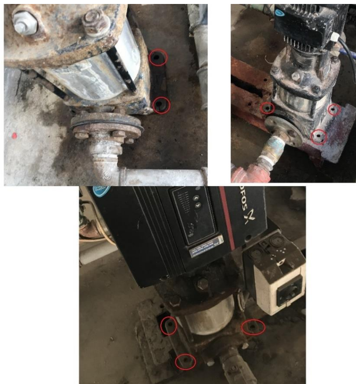
Figura 22- Ilustração da falta dos pinos de fixação
