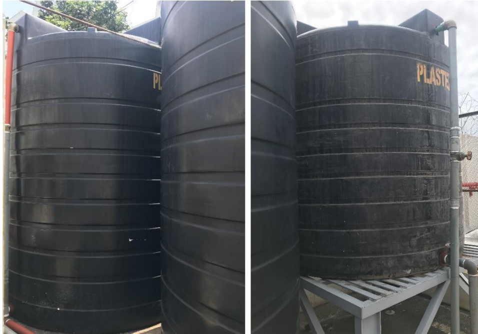
Figura 17- Reservatório de sucção
