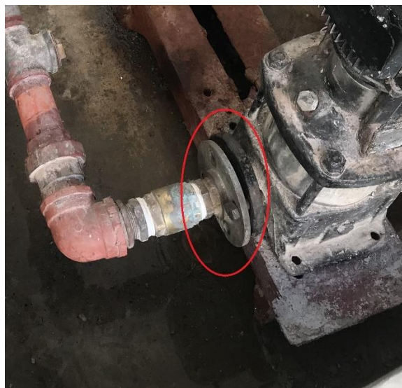
Figura 24- Ilustração da causa de vazamento da bomba 2
