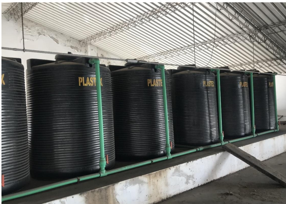
Figura 18- Reservatório de recalque
