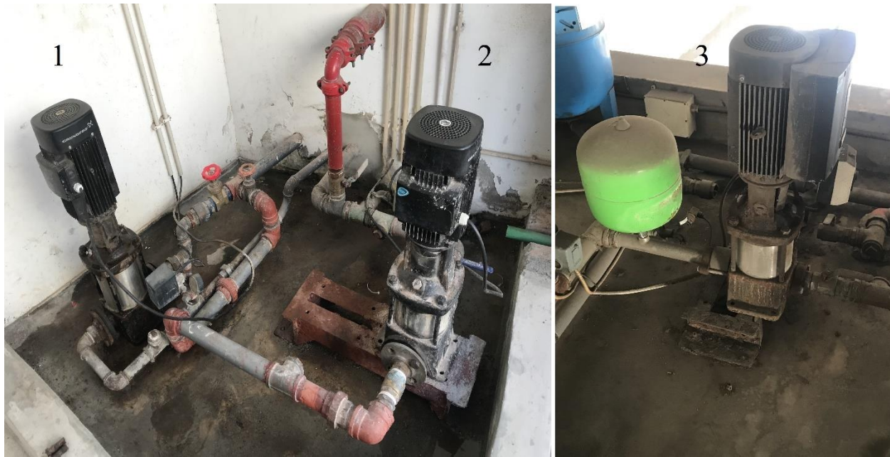
Figura 14-Conjuntos Motor-bombas do Sistema
