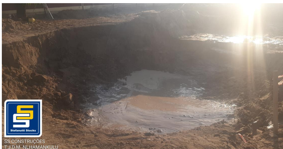
Figura 2 : Presença de lençol freático no terreno
