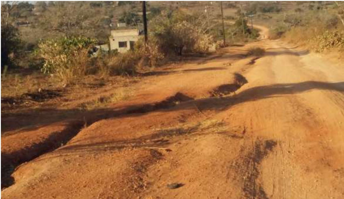
Figura 7: Ilustra erosão nas vias de acesso
