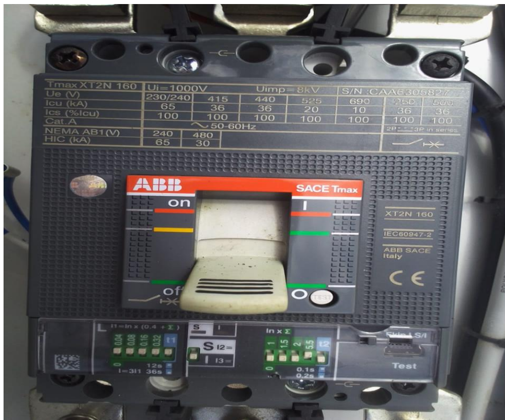
Figura Anexo 7.2-8 Disjuntor seleccionado para à instalação
