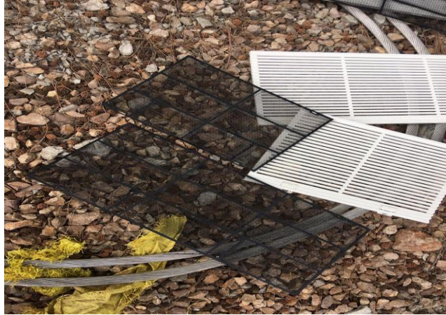
Figura 17-3: Limpeza dos filtros de ar (Fonte: Autor)
