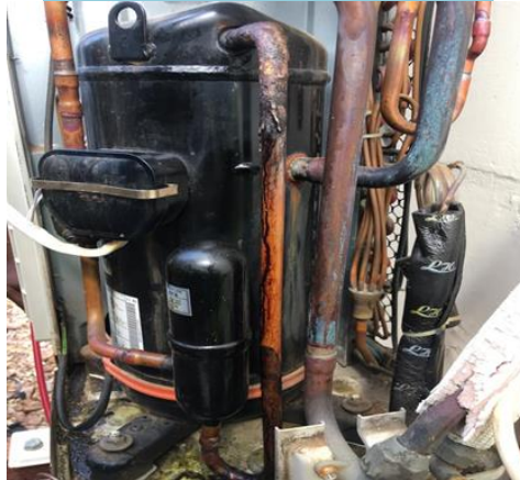
Figura 9-3: Unidade condensadora, subestação da EDM, (Fonte: Autor).
