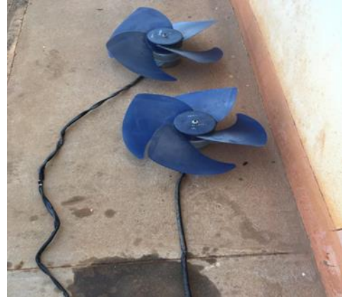
Figura 11-3: Motores de ventilação em estado crítico EDM - SE8, (Fonte: Autor)
