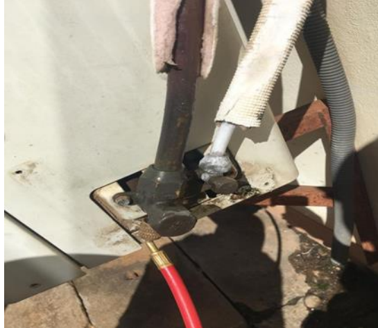
Figura 12-3: Conduta de líquido/expansão congelada, EDM-SE8 (Fonte: Autor)
