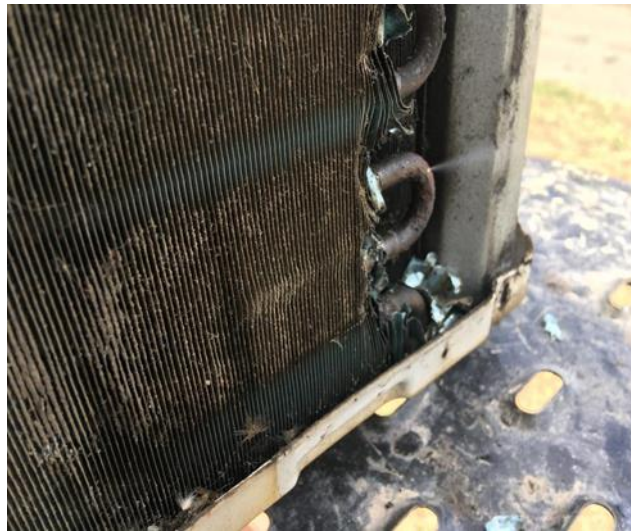
Figura 8-3: Unidade condensadora do DEP de Segurança Rodoviária da ANE (Fonte: Autor).
