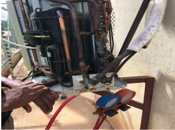
Figura 10-3: Unidade condensadora avariada, EDM - SE8, (Fonte: Autor)
