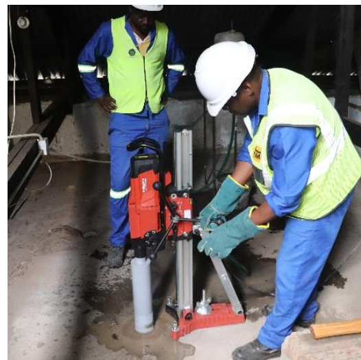
(b) Na laje de cobertura acima do quarto 3
