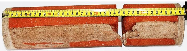
(d) Carote extraída na parede exterior ao nível da cave (parede com espessura de 39 cm – um tijolo disposto na transversal e outro na longitudinal)
