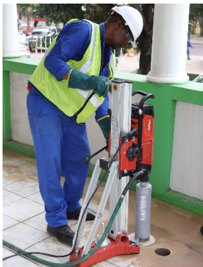
(a) Na laje do piso 2, na zona da varanda
