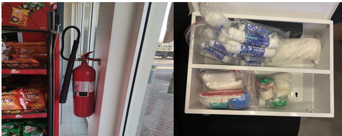
Figura 11: Extintor de incêndio e caixa de primeiros socorros (Fotografia da autora)
