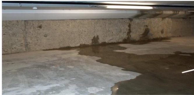
Figura 15 Problema de execução das paredes moldadas (Fonte: Borrego Aldeias, 2011)
