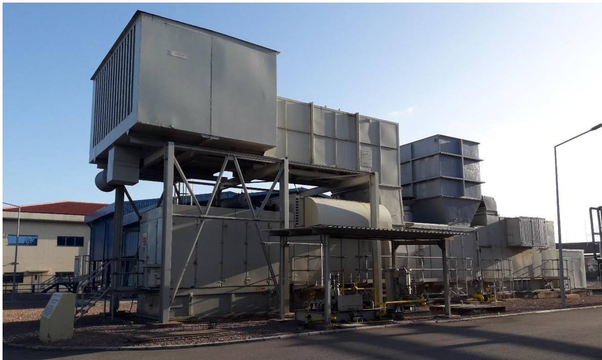
Figura 3.2: Vista do Grupo Turbina a Gás n.º 3 (GTG 3) [Autor]
