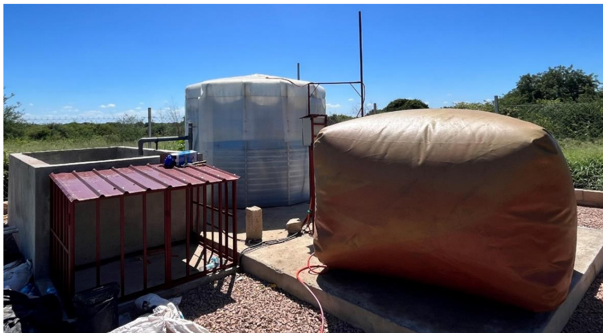
Figura A5-5: Planta de biogás.
