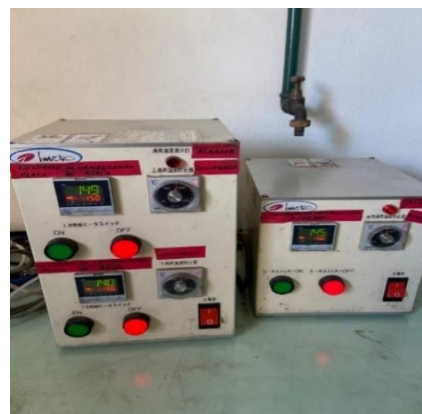
B - Painel de controlo temperatura
