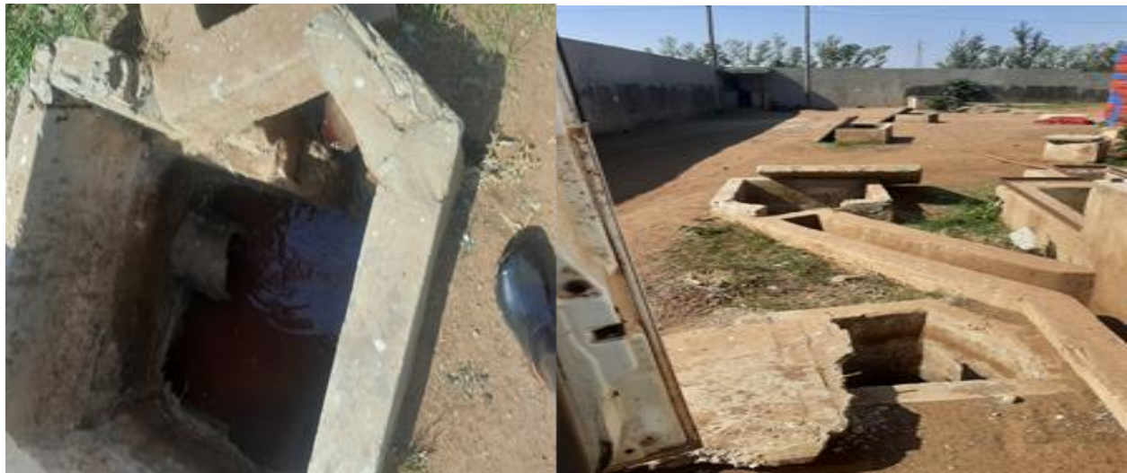
Figura 6. Drenagem água residual (Tanque fora das salas e Caracol de condução)
