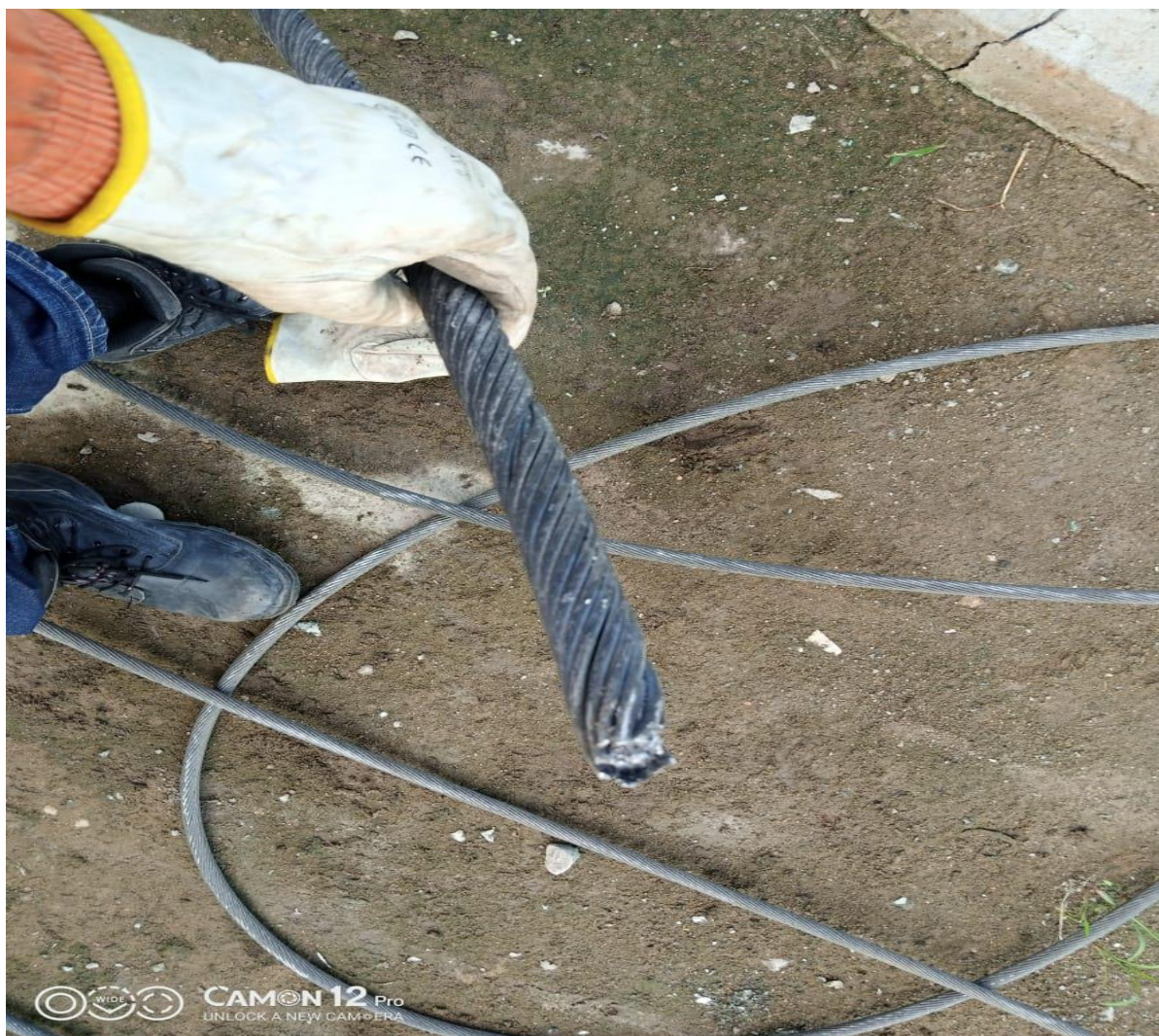
Figura A 3-1: Condutor rompido da Antiga DL4
