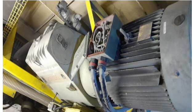
Figura 20-Motor eléctrico acoplado com o compressor
