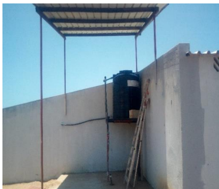
B -Tanque de abastecimento de água-Chamissava
