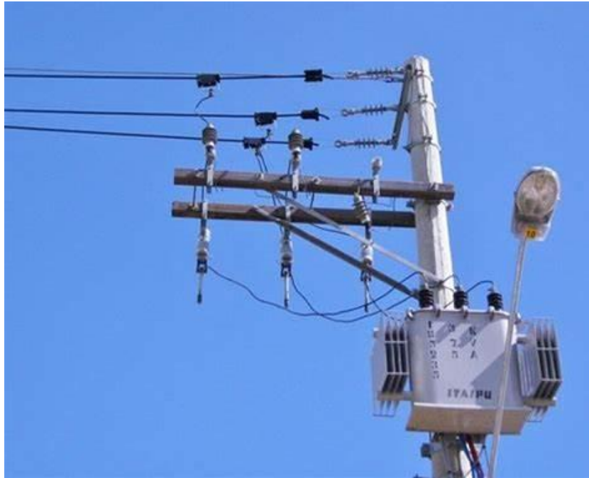
Figura 1: Rede aérea de MT (Fonte: glengenhariaeletrica.com.br)
