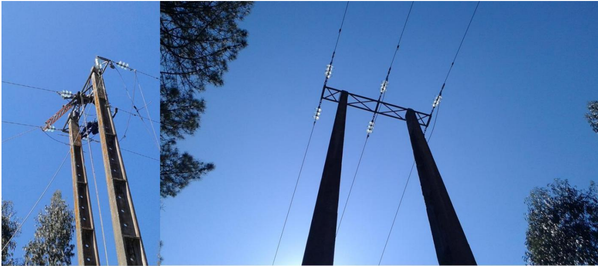
Figura 3: Passagem de uma linha aérea de MT (Fonte: comum.rcaap.pt)
