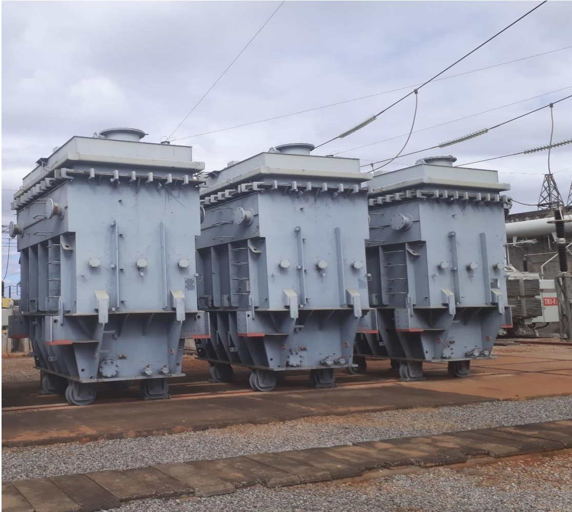
Figura A7-15: Transformador de potência 3 a ser implementado na SE de Chibata (Fonte: O autor, 2024)
