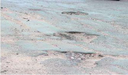
figura 13: Estradas degradadas Fonte: Jornal Evidências
