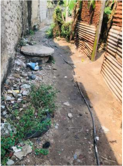
Figura46: Tubos desenterrados Fonte: Autor
