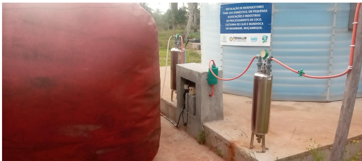
Figura A. 2.4-10: Sistema de Biodigestores em fase de teste na cooperativa Josina Machel Fonte: O Autor
