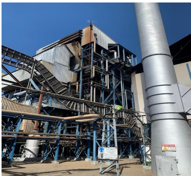
Figura 3: Vista exterior da caldeira aquatubular na fábrica açucareira de Xinavane (Fonte: autor).
