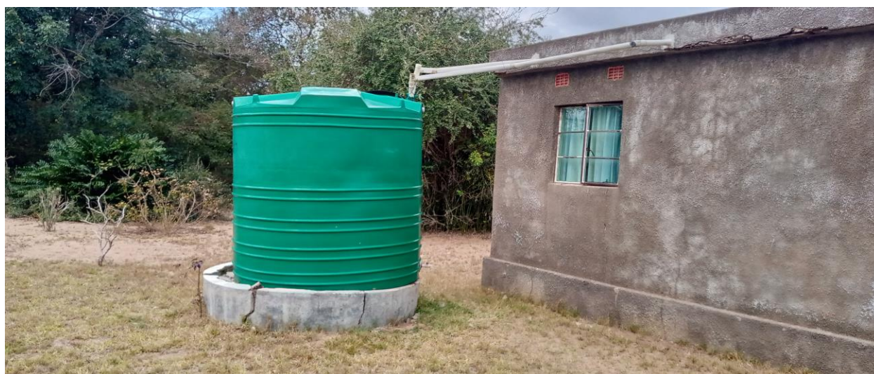
Figura 4.5: Tanque com um sistema convencional para a captação das águas das chuvas
