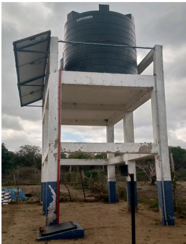
Figura 4.4: Sistema de abastecimento de água na comunidade (obsoleto)
