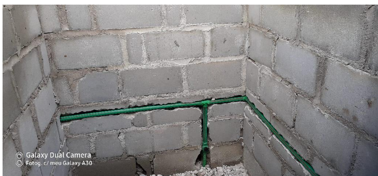
Tubos de abastecimento
