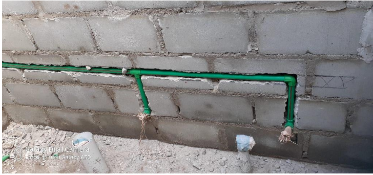
Tubos de abastecimento
