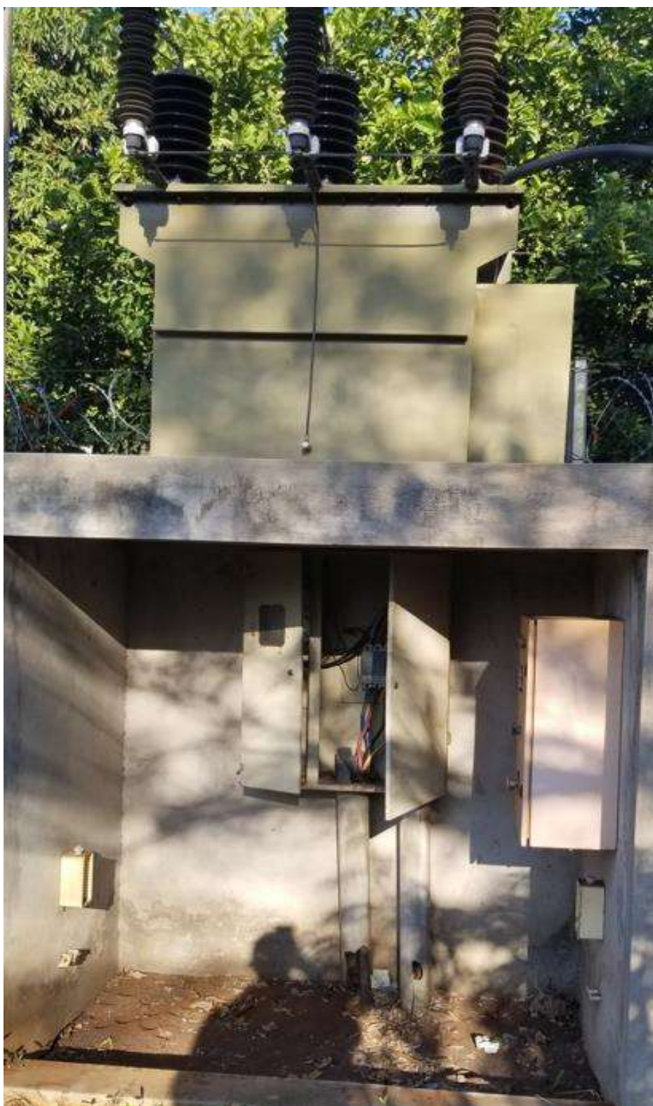
Figura A11-11: Posto de transformação de energia eléctrica. (Fonte: Autor)
