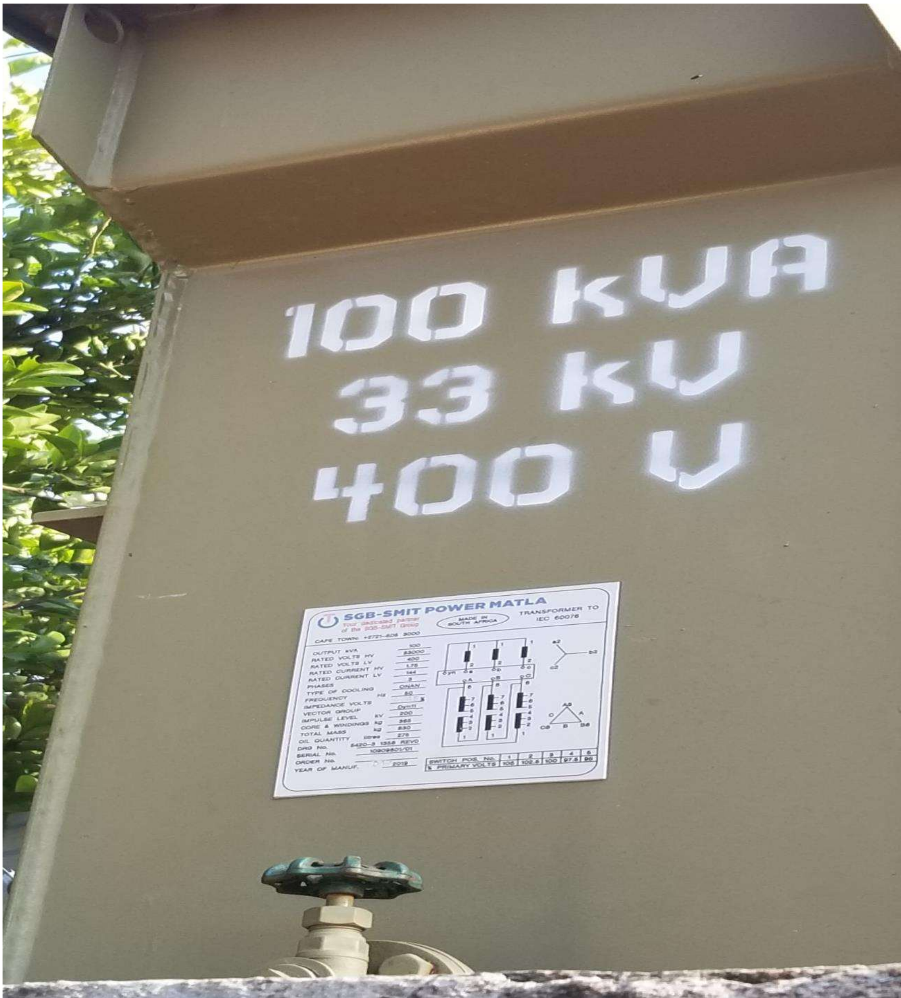
Figura A10-10: Dados de chapa de características do transformador. (Fonte: Autor)
