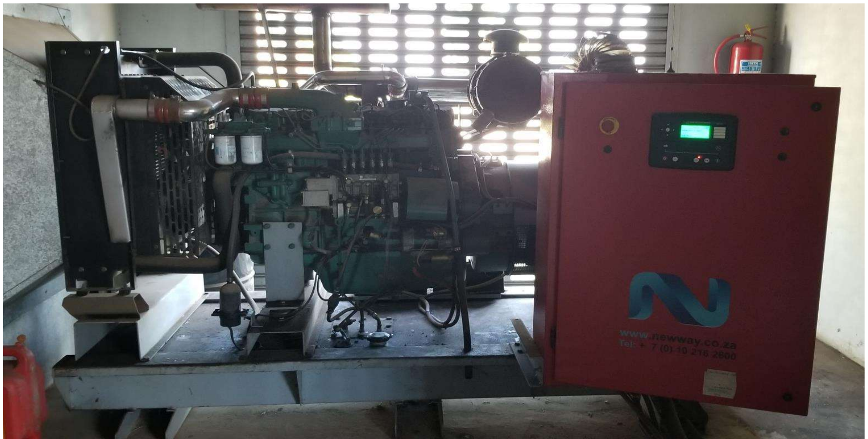
Figura A14-14: Chapa de características do grupo gerador de 135 KVA. (Fonte: Autor)
