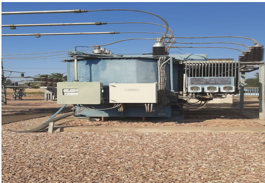
Figura A 3.1-5: Transformador 2 SE9.
