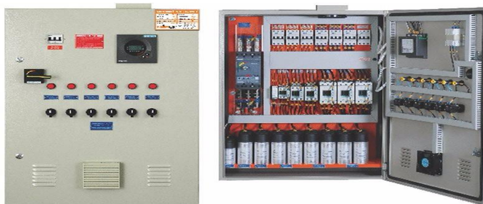
Figura 10: Banco de capacitor instalado.
