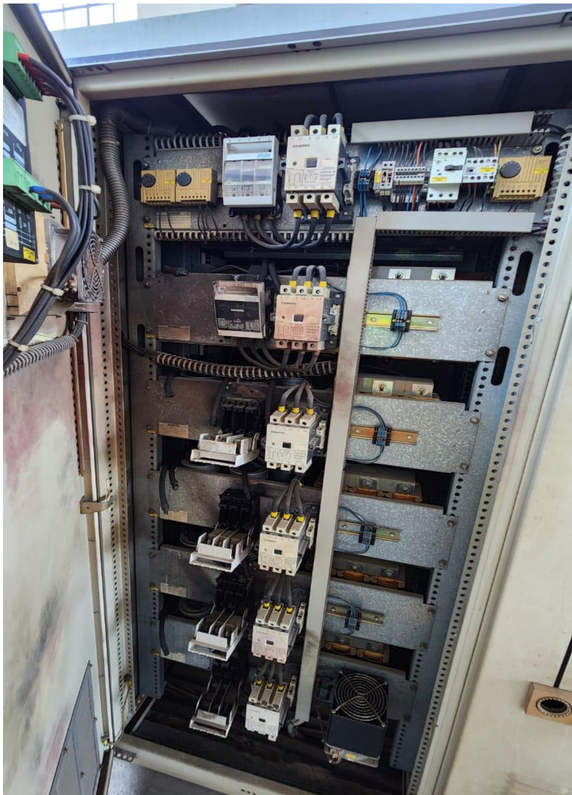
Figura A3-4: Banco de condensador na S1.2/ (Fonte: O autor,2025)
