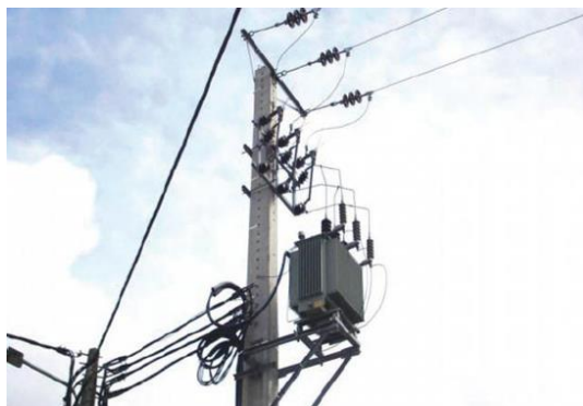
Figura 20: Transformador em poste de betão. (Fonte: Autor)
