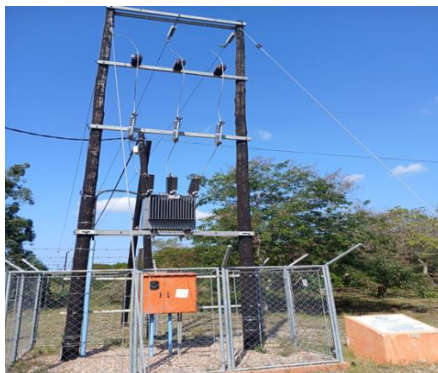
Figura 21: Transformador em pórtico de madeira. (Fonte: Autor).
