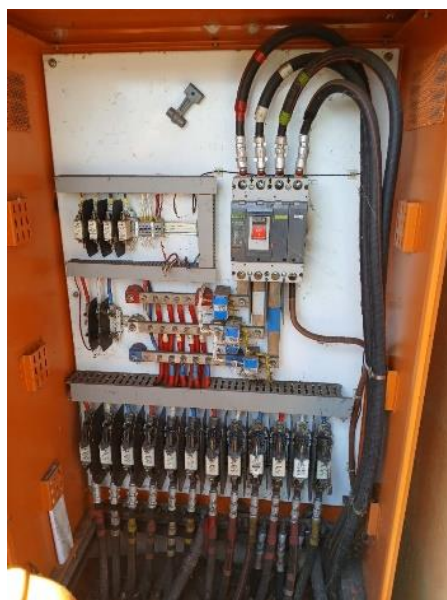
Figura 25: Quadro geral de Baixa tensão. (Fonte: Autor)
