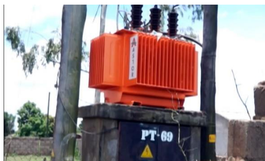
Figura 22: Transformador assente em base de alvenaria (Fonte: Autor)
