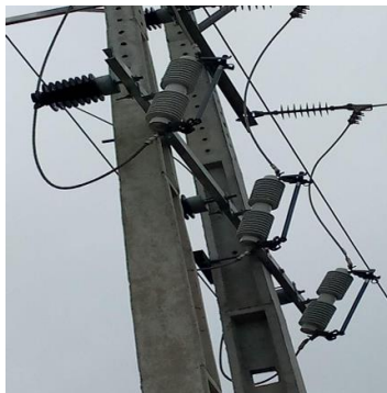
Figura 29:seccionador do tipo Drop-out fuse link (Fonte: Autor)
