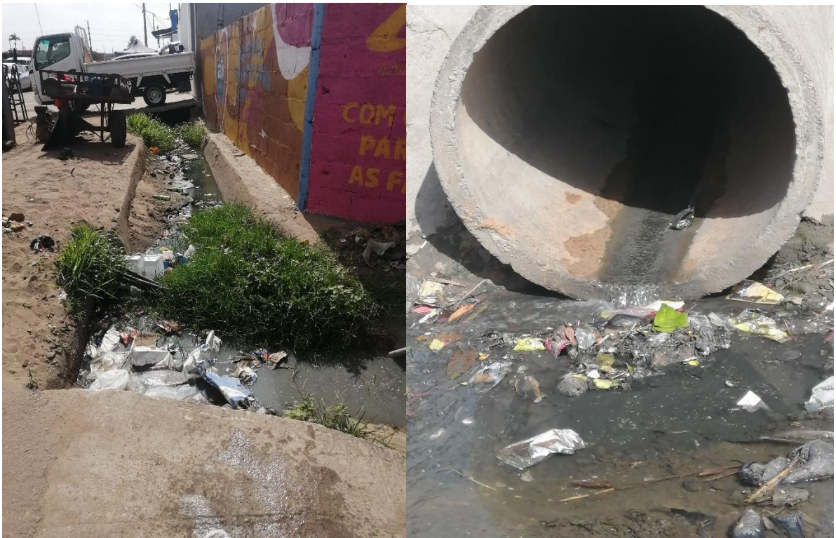
Figura 9. Sistema de drenagem de água residual na Bacia do Rio Infulene
