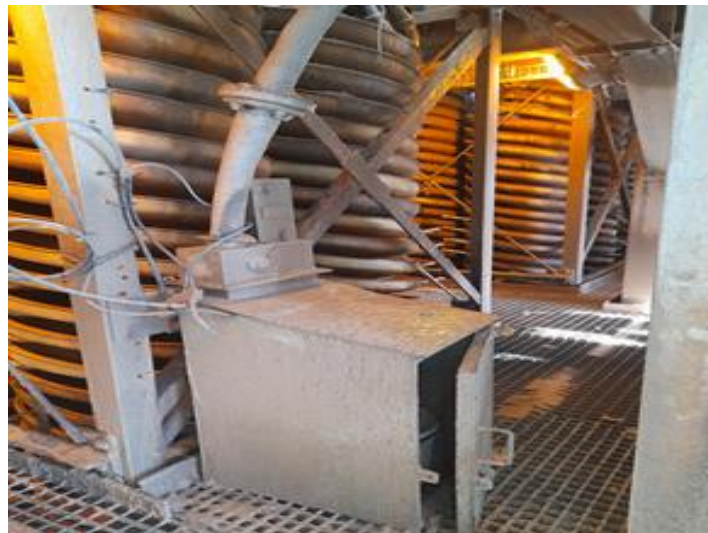
Figura 17: amostrador automático da RSF
