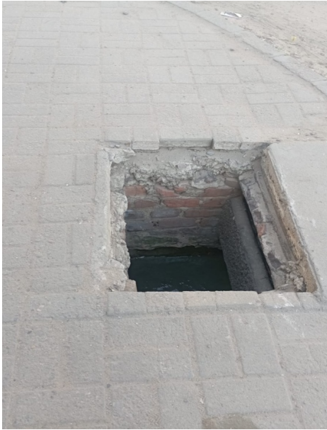
Imagem 1: Dreno de águas pluviais não concluído Av.Karl Marx
