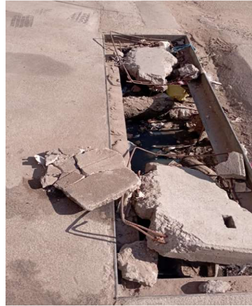
Imagem 2: Boca de lobo em estado de degradação Av. Guerra popular
