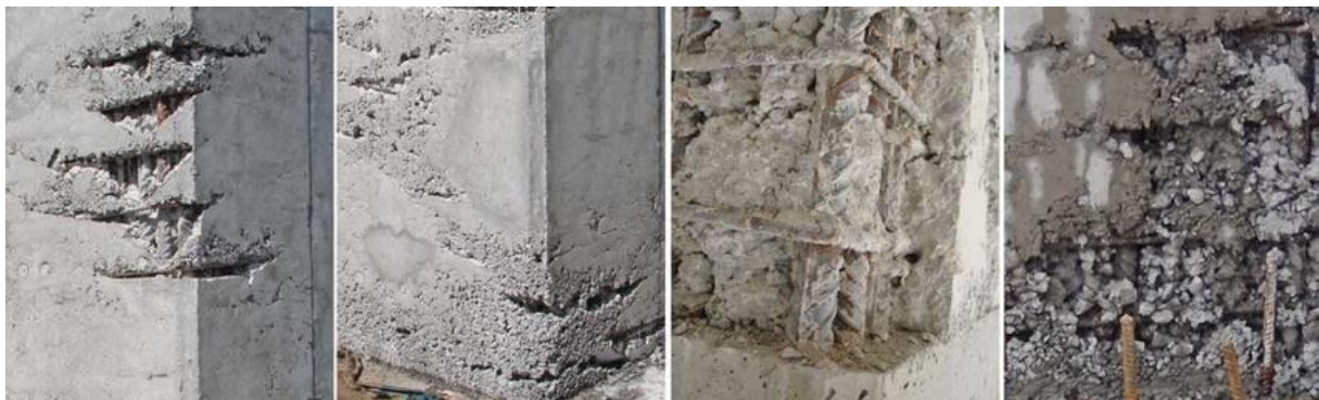
Figura 4. Vazios e recobrimento inadequado das armaduras no betão tradicional.
