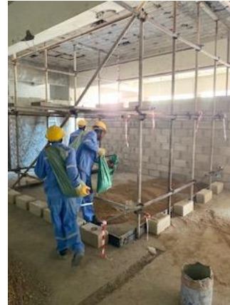
Figura 19. Zona de contenção para abertura da laje para instalação de escadas metálicas
