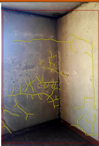
a19.6) fissuras irregulares e ramificadas na parede; b12.6) manchas de humidade com eflorescências
