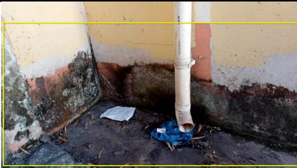
b86) manchas de humidade com destacamento do acabamento e fungos
