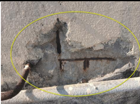
d2.7) descolamento do betão; c1.7) exposição e corrosão das armaduras
