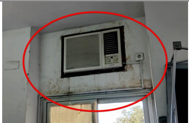
b12.3) manchas de humidade ao redor do aparelho de ar condicionado
