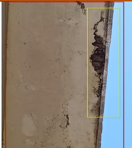
b104) destacamento do acabamento, presença de bolhas na superfície inferior da laje; d16) destacamento do betão; c4) exposição e corrosão das armaduras
