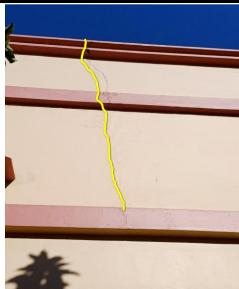
a107.1) fissura vertical ao longo na parte superior da parede
