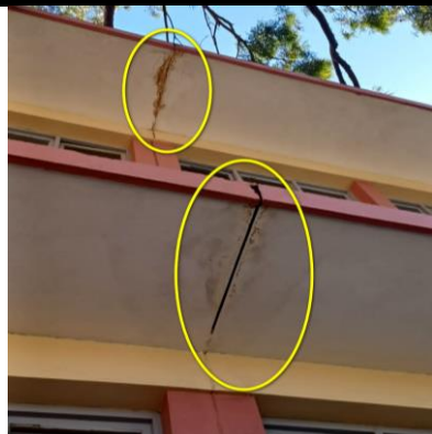
b110) e b65.1) manchas de humidade na zona da junta de dilatação; d21) destacamento do revestimento
