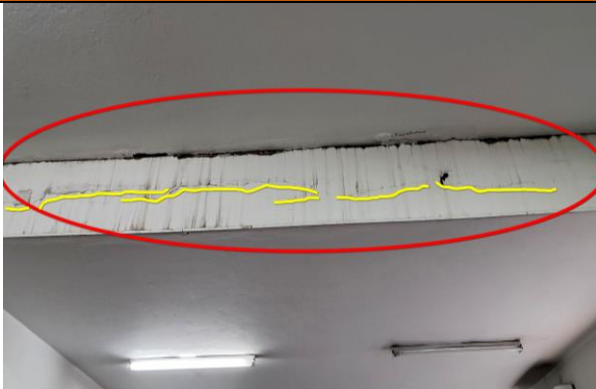
a56) fissuras na laje; b68) manchas de humidade acompanhando as fissuras
