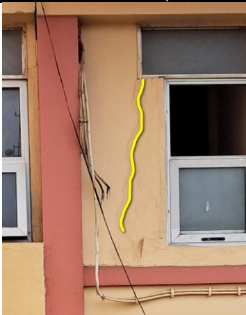
a91.1) fissura vertical entre a janela e o pilar, próximo da junta de dilatação
