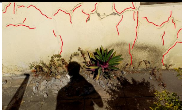
a98) fissuras ramificadas na parte inferior da fachada; b94) manchas de humidade; g1) presença de vegetação junto à base na parede;
