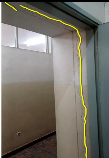
a25) fissuras sob o vão da porta
