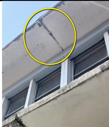
b61.1) manchas escuras e claras de humidade ao redor da junta de dilatação, com destacamento do acabamento; d9.1) destacamento do revestimento da laje; c2.1) exposição e corrosão das armaduras.
