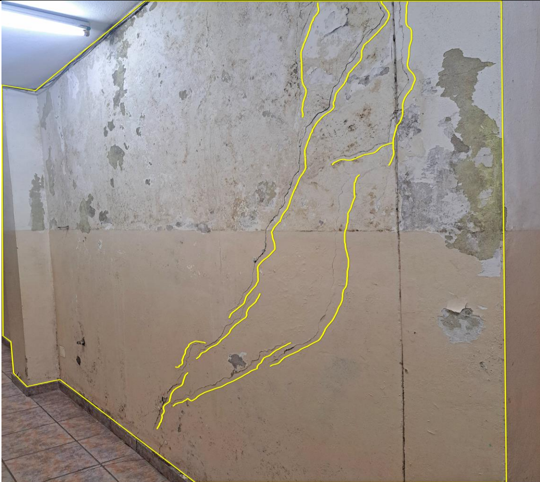
a18) fissuras inclinadas na parte inferior da parede; fissura vertical no pilar; b40) manchas de humidade com bolhas, eflorescências, descolamento do acabamento.
