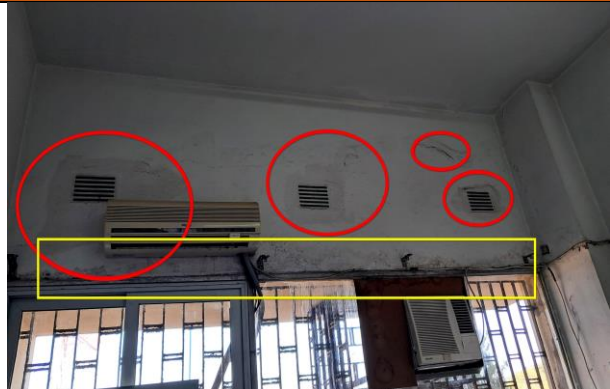
b69) manchas de humidade na parte superior da parede
