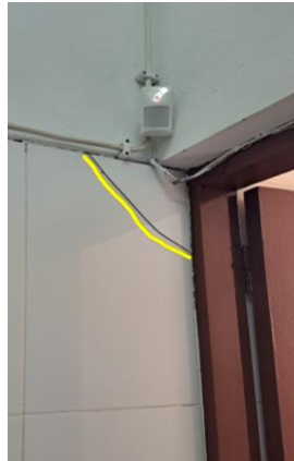
a79.1) fissura inclinada no revestimento da parede
