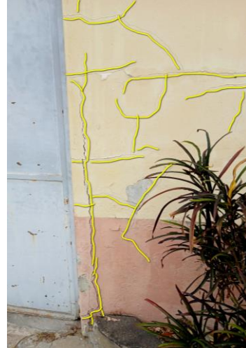
a76) fissuras ramificadas na parede
