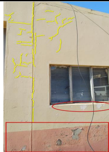
a77) fissuras ramificadas, fissura vertical acompanhando a junta de dilatação; b82) manchas de humidade com bolhas e destacamento do acabamento
