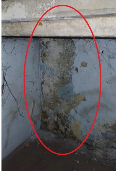
b13) manchas de humidade na parte inferior da parede
