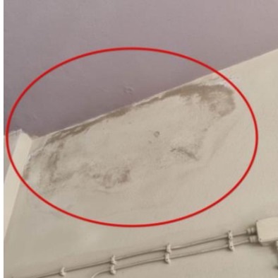
b1.1) manchas de humidade na parte superior da parede
