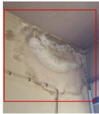
b2.1) manchas de humidade, com eflorescência com presença de eflorescências
