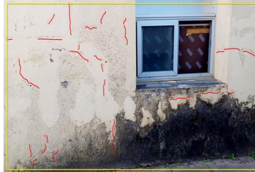
a107) fissuras verticais e paralelas entre a base do pano e o contorno da janela; b99) manchas humidade escuras na parte inferior da parede e crescimento biológico
