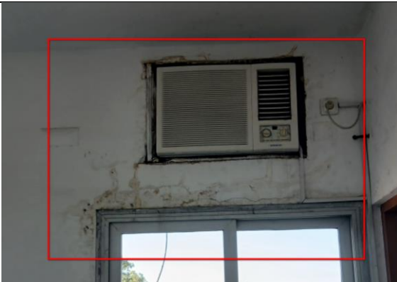
b11.3) manchas de humidade ao redor do aparelho de ar condicionado
