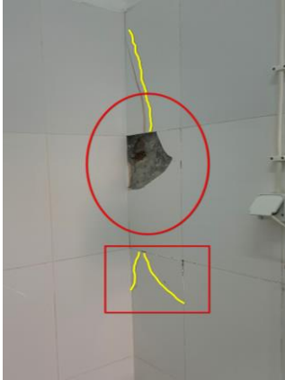
a78.1) fissuras inclinadas no revestimento; d7.1) destacamento do revestimento da parede
