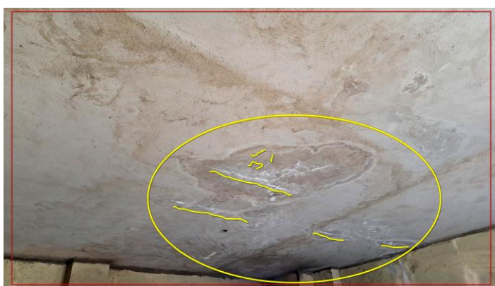
a22.6) fissuras lineares e irregulares na laje; b16.6) manchas de humidade com eflorescências
