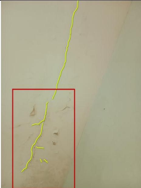
a47) fissuras contínuas e ramificadas na laje; b65) mancha de humidade com descolamento do acabamento ao redor da fissura
