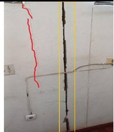
a22) fissura vertical próxima da junta de dilatação
