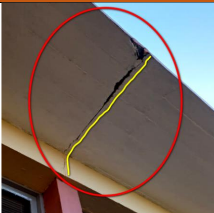
a125) fissura profunda com abertura considerável na laje; d18) destacamento visível no bordo livre da laje
