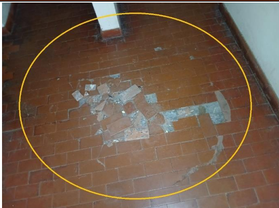
d1.2) levantamento de placas cerâmicas do piso
