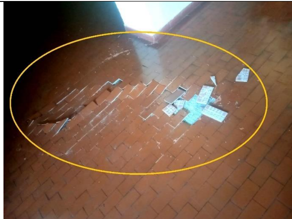
d8.1) levantamento de placas cerâmicas do piso
