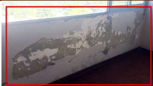
b1.4) manchas de humidade com destacamento do acabamento sob o vão da janela
