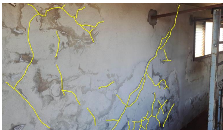
a26.6) fissuras irregulares na parede; b18.6) manchas de humidade com eflorescências e destacamento do acabamento
