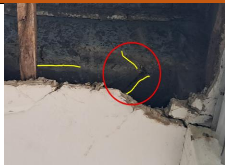
a58) fissuras na viga e no pilar; d8) descolamento do betão na viga e no topo do pilar, com perda evidente do recobrimento e possível corrosão de armaduras
