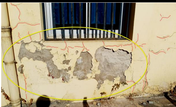
a97) fissuras irregulares localizadas nas bordas do vão da janela e na base da fachada; d14) destacamento do revestimento da parede
