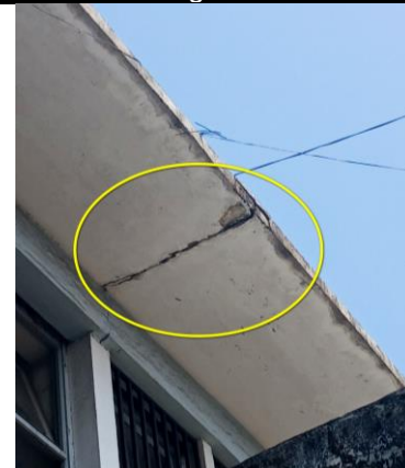
b62.1) manchas escuras e claras de humidade ao redor da junta de dilatação; d10.1) destacamento do revestimento da laje; c3.1) exposição e corrosão das armaduras.
