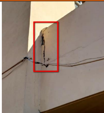
a126) fissura profunda; d19) destacamento do revestimento na ligação entre dois blocos
