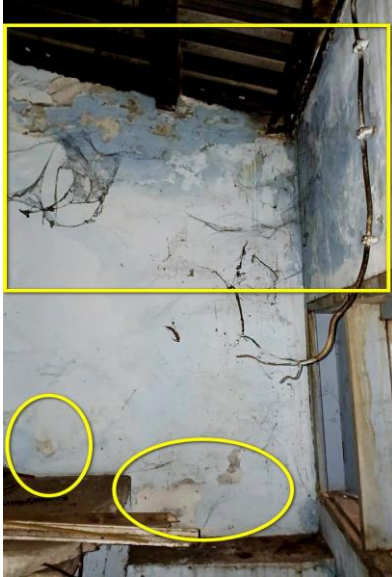
b12) manchas de humidade com presença de eflorações na parede
