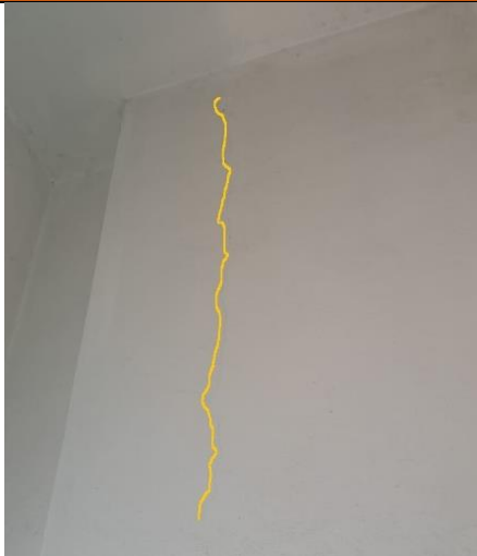
a5.5) fissura vertical contínua na parede
