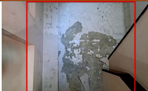
b9.3) manchas de humidade com presença de bolhas e destacamento do acabamento
