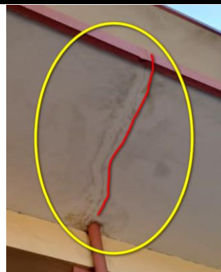
a130) fissura no painel da laje em consola; b111) mancha de humidade localizada ao redor da fissura na laje
