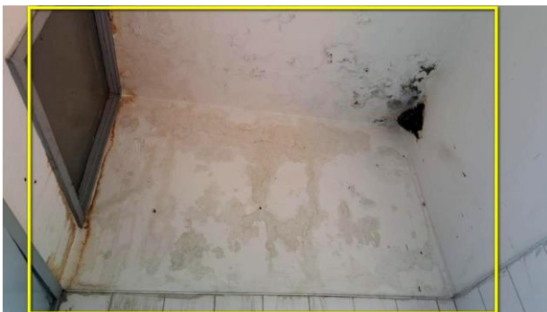
b8.3) manchas de humidade com escorrimento e fungos na laje
