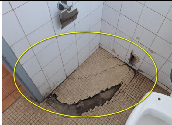
d2.2) destacamento do revestimento de piso; c1.2) corrosão das armaduras
