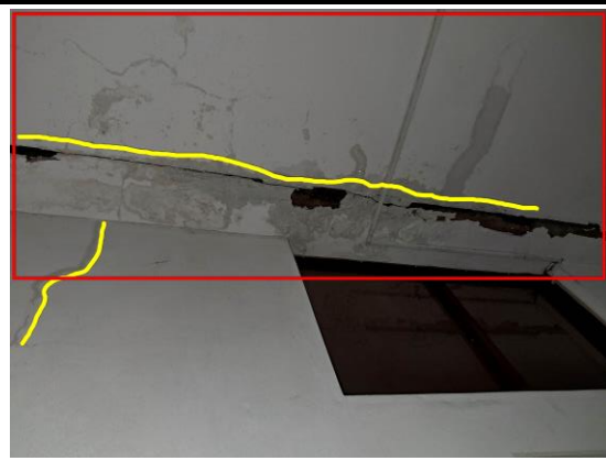
a72.1) fissuras na separação entre blocos, na laje e na parte superior da parede; b42.1) manchas de humidade ao redor das fissuras na parede e na laje; d5.1) destacamento do revestimento na laje, junto à junta de dilatação
