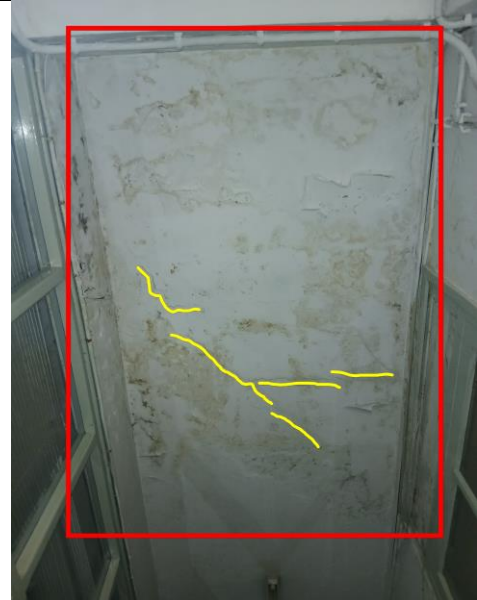
a14) fissuras inclinadas na laje; b35) manchas de humidade na superfície inferior da laje e descolamento do acabamento
