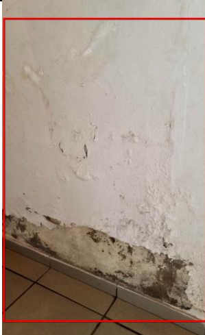
b6.1) manchas de humidade com presença de eflorescências, bolhas e destacamento do acabamento
