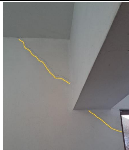
a6.5) fissura inclinada na parede e junto a ligação com a viga
