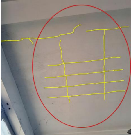
a47.1) fissuras em malha na laje; b37.1) manchas de humidade ao redor das fissuras
