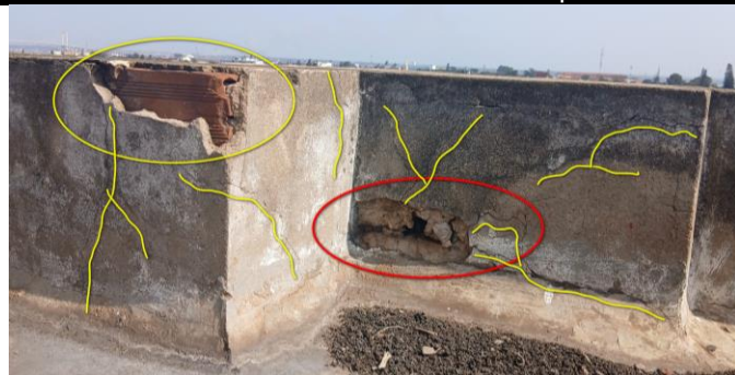
d3.7) descolamento do revestimento da platibanda; d4.7) descolamento do betão (zonas fragmentadas de betão); c2.7) exposição e corrosão das armaduras; a5.7) fissuras horizontal e inclinadas na platibanda; b4.8) manchas humidade com presença de eflorescências
