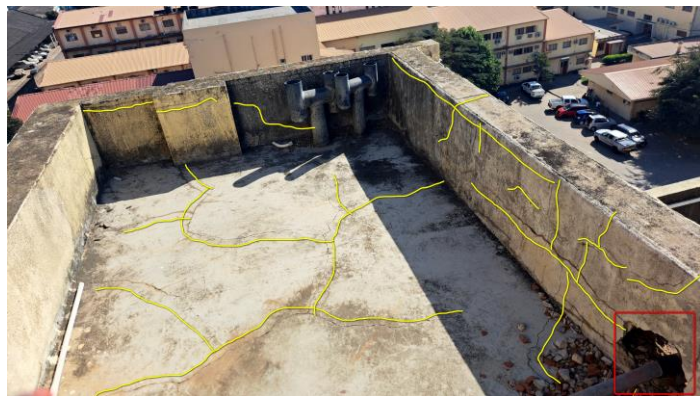
a3.7) fissuras irregulares na laje de cobertura; a4.7) fissuras horizontais, inclinadas e ramificadas na platibanda; b2.7) manchas escuras de humidade tanto na superfície da laje de cobertura assim como na platibanda; d1.7) descolamento e buraco na base da platibanda
