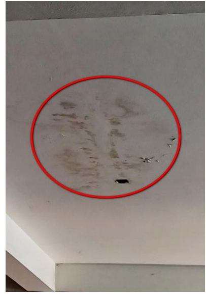
b14) manchas de humidade na laje com descolamento parcial do acabamento; d3) descolamento do revestimento
