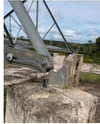
Figura 10 Torre derrubada pela base em Vilhena, RO — Foto: Aneel/Divulgação
