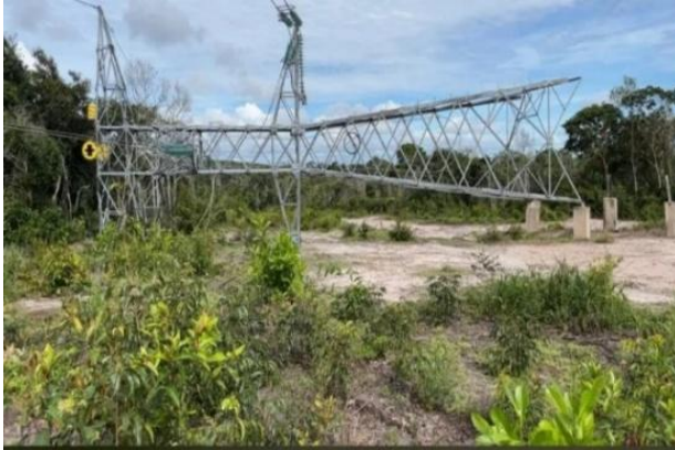
Figura 9 Torre de Energia Derrubada em Rondônia no Brasil — Foto: Aneel/Divulgação
