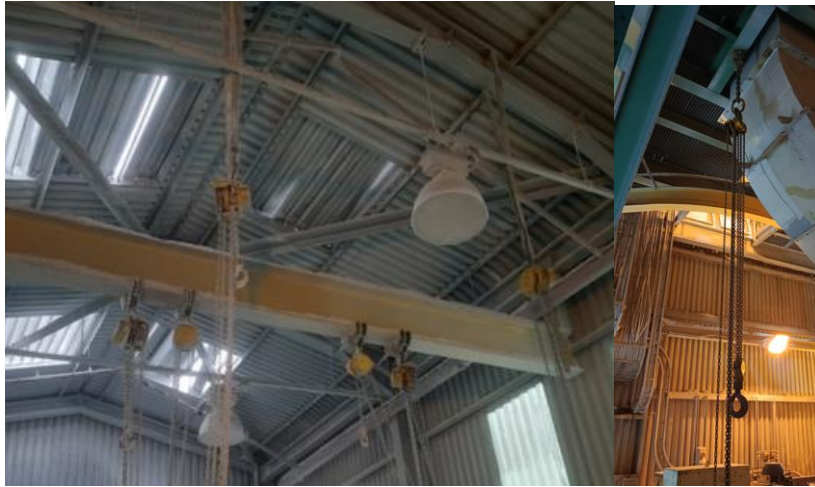
Imagem 5: Equipamento de elevação mantido suspenso na planta por período prolongado
