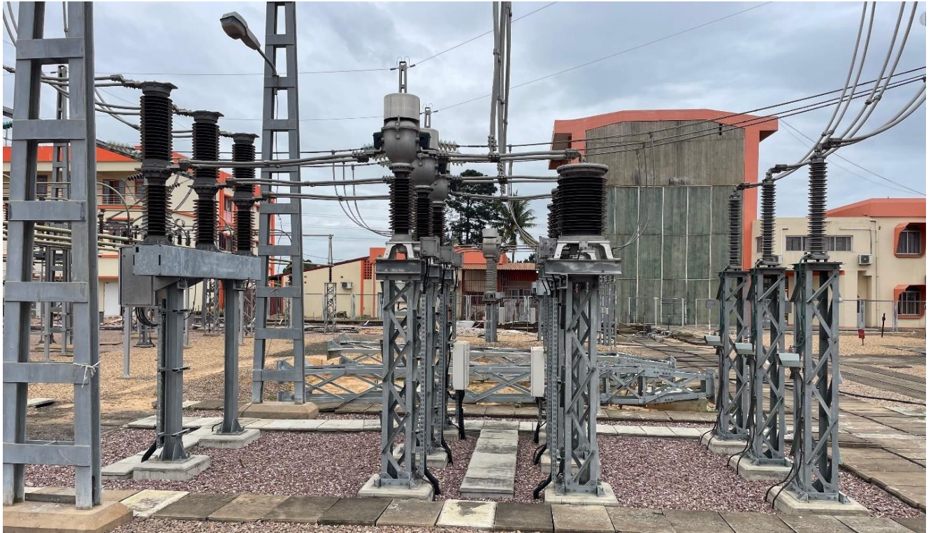
Figura 2: Exemplo de um painel eléctrico exterior
