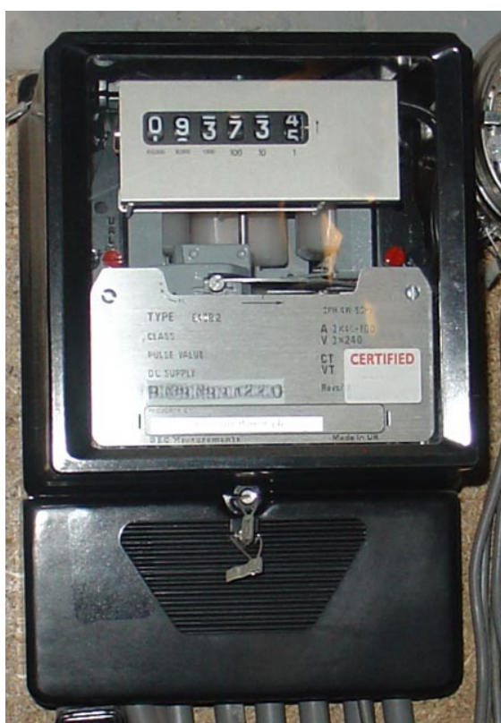
Figura 2.7: Medidor Electromecánico Fonte: https://pt.wikipedia.org/w/index.php?title=Medidor_de_energia_el%C3%A9trica&action=info
