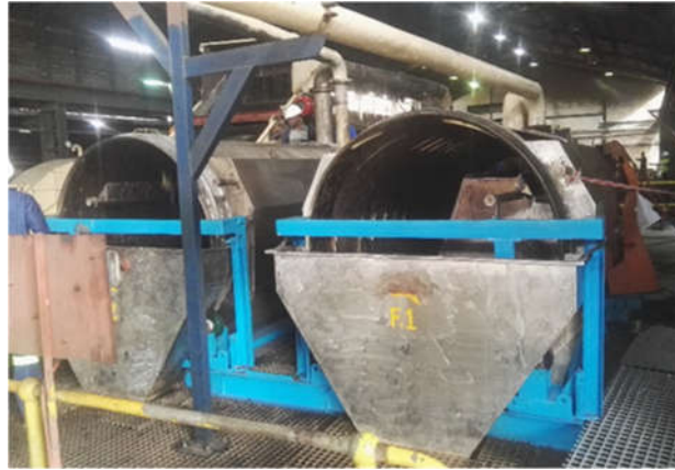
Figura 16: Filtros rotativos em uso na TH ADM [Autor]
