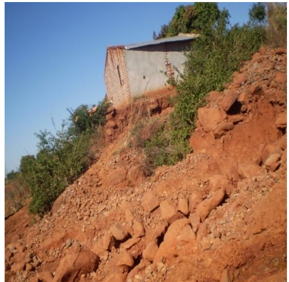
Figura 16. Casa cercada por fendas causadas pelo garimpo no povoado de Chadzuca. Fonte: O autor-18/07/2014
