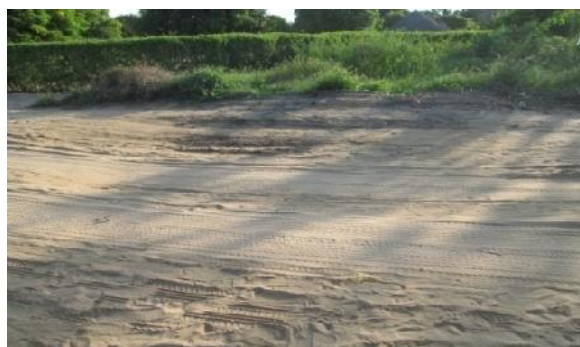
Figura nº 10 Drenagem inadequada da estrada Vilankulo Madeira – Chibuene
