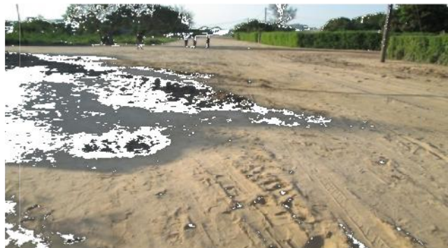
Figura nº 12 Buracos na Vilankulo Madeira – Chibuene
